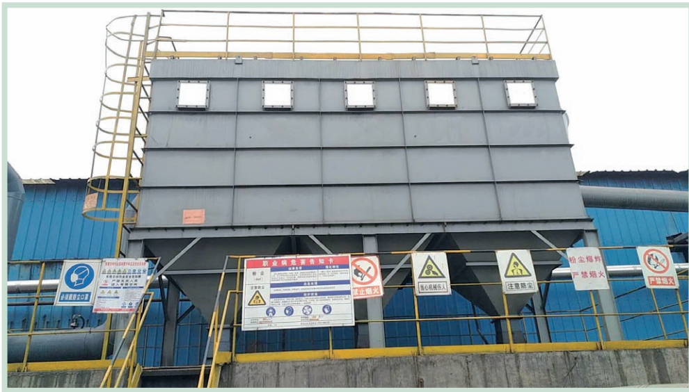
改造後的防爆除塵器
